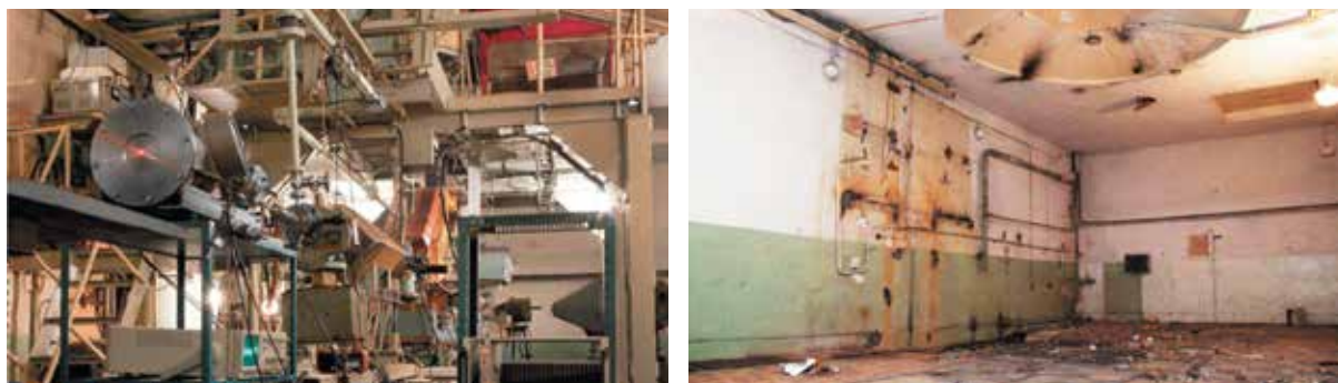
Рис. 5.47 – Вывод из эксплуатации ускорителей ЭГ-1 и ЭГ-2,5 в здании № 155. Помещение № 161 до и после завершения демонтажных работ
