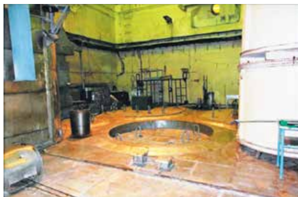
Рис. 5.24 – Общий вид колодцев выдержки в помещении 093
