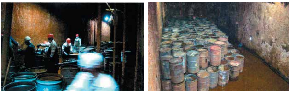
Рис. 5.12 – Сбор иловых отложений в ТУК типа АФИБ на дне одного из отсеков и складирование заполненных ТУК
