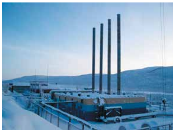
Рис. 5.7 – Блочно-модульная котельная на Билибинской АЭС
